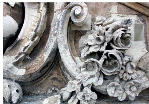
Détails du fronton Sud avant restauration
